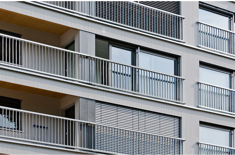
Abb. 54: In die Fassaden integrierte Raffstorekästen
